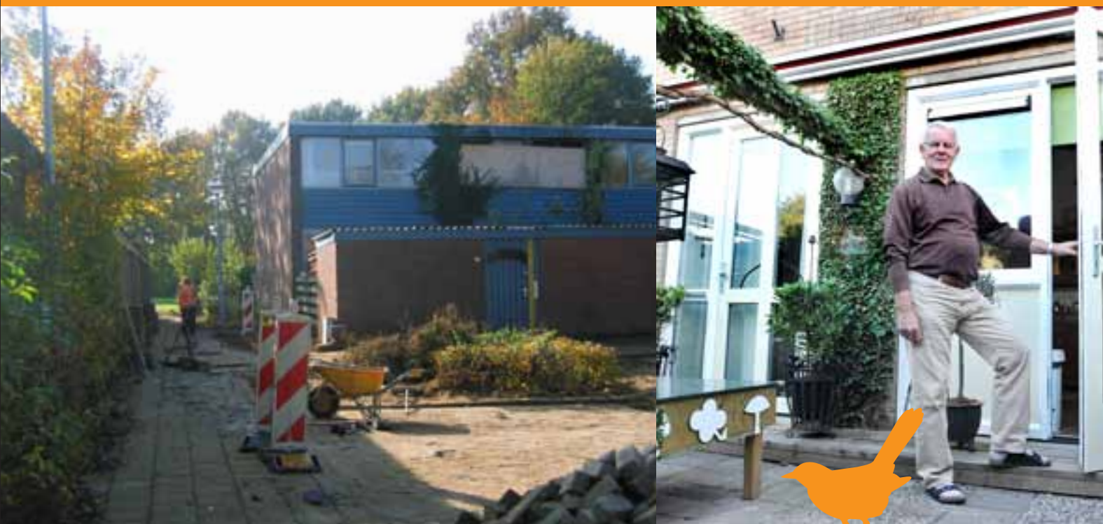
Momenteel worden in Het Bosveld de kabels en leidingen verlegd. Onder andere om ruimte te maken voor de bouwwerkzaamheden.
